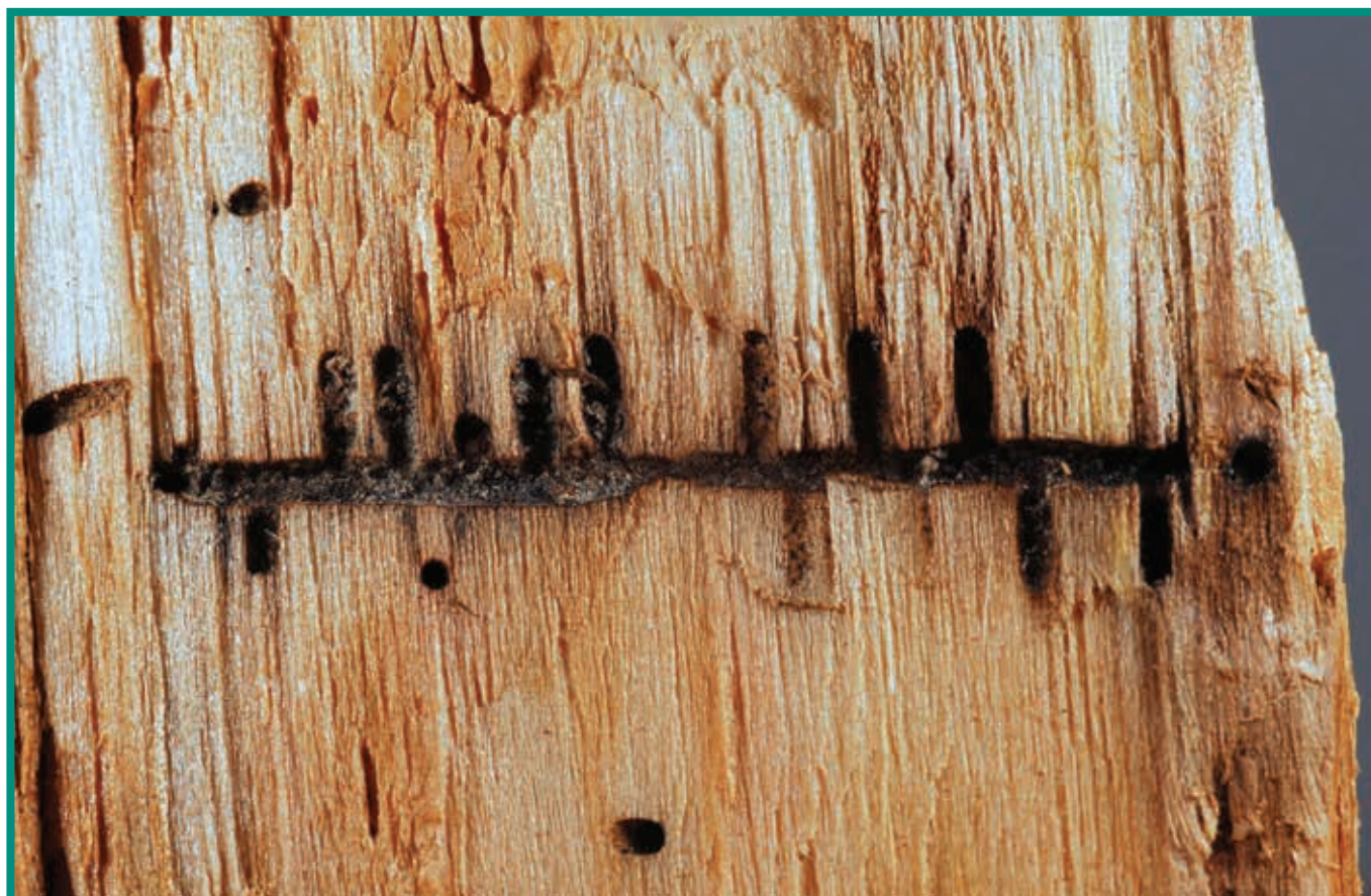
Żerowanie larw kornika drwalnika paskowanego powoduje uszkodzenia techniczne drewna (fot. RP)
